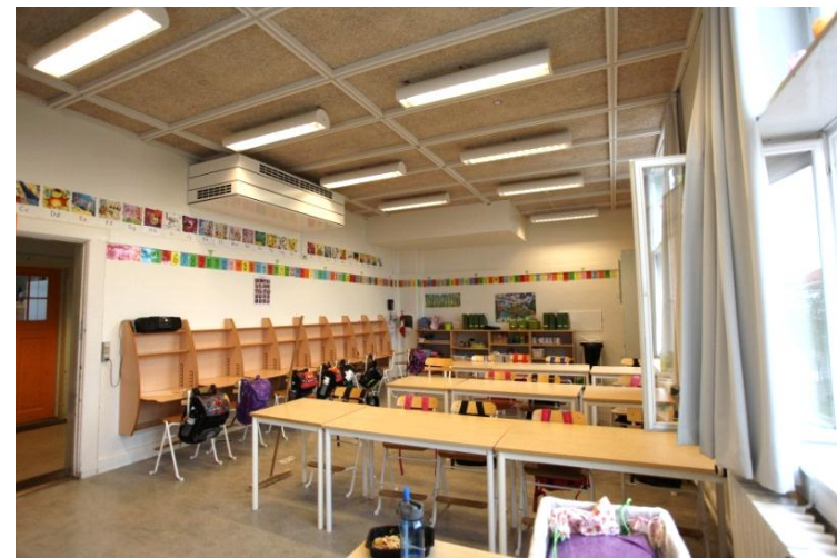
Figur 12. Synligt decentral ventilationsinstallation delvist integreret som endnu en kasse i loftet.
