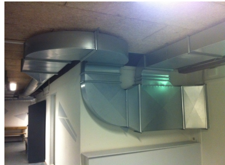
Figur 53 Central balanceret ventilation med kanalerne ført på taget.
